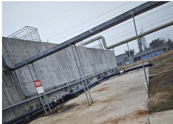
图 2.3-4 现有项目事故应急池建设情况
