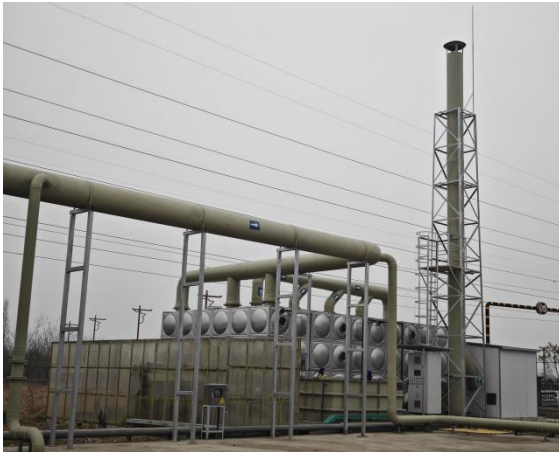
生物除臭现场图
