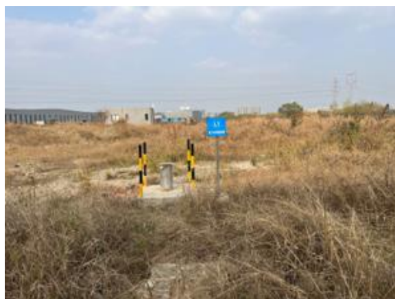
1#地下水检测井
